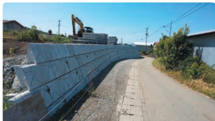
熊本地震 離合問題を解消する生活道路整備 緊急搬送や避難経路の確保
