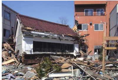
被災直後の角星店舗
