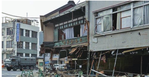
被災直後の武山米店店舗
